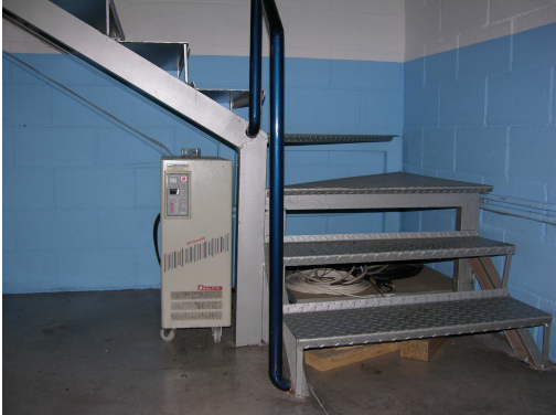
DETALLE UPS-SAI, BAJO ESCALERAS.
