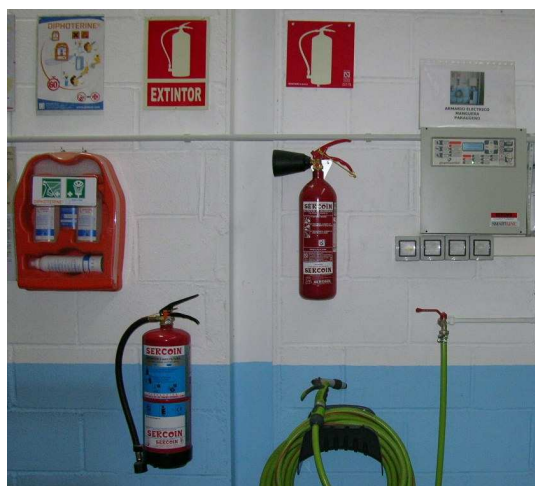
EXTINTORES: PEQUEÑO CO2, GRANDE ESPUMOGENO
