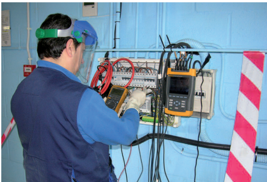
Entre otros EPI, Protón surte a sus trabajadores con diversos tipos de guantes (dieléctricos, látex, piel, nitrilo, térmicos), pantalla facial contra el arco eléctrico y calzado aislante
